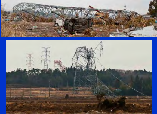
鉄塔の被害: 振動・津波(相馬)
